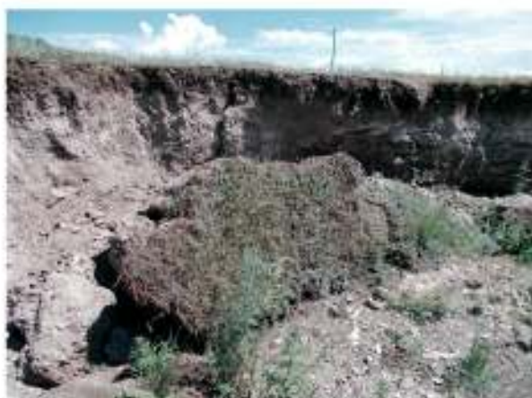
Рис. 59 Разрушение бортов оврага на пункте Уюкский в районе с. Уюк Пий-Хемчского района, Республика Тыва
