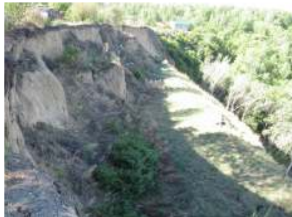
Рис. 145 Разрушение оползневого блока в СНТ «Обь». Четвертый оползневой район, г. Барнаул, Алтайский край (2021 г. – фото сверху, 2022 г. – фото снизу)
