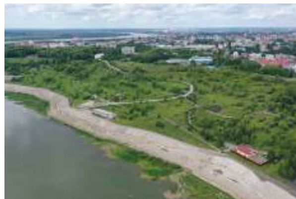
Рис. 169 Противооползневые сооружения на пункте наблюдений Лагерный сад в г. Томске, Томская область
