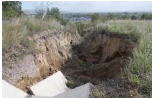
Рис. 151 Овраг на участке автодороги Р-255, 29 км. Емельяновский район, Красноярский край
