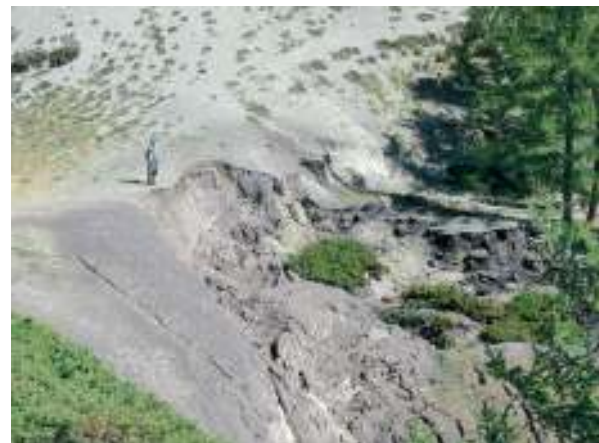
Рис. 140 Расширение оврага вблизи водовыпуска. Пункт наблюдений Джазаторская трасса, Республика Алтай
