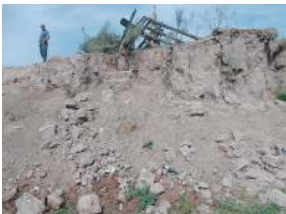
Рис. 141 Разрушение бортов оврага на пункте Уюкский в районе с. Уюк Пий-Хемского района, Республика Тыва
