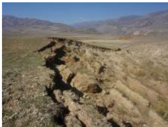
Рис. 138 Блоки и трещины отпора в вершине оползня № 55. Пункт наблюдений Чуйский, Республика Алтай
