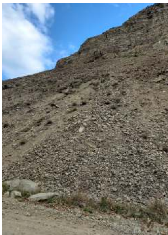
Рис. 143 Осыпи на участке автодороги Кызыл – Баян-Кол, 23 км, Кызылский район, Республика Тыва
