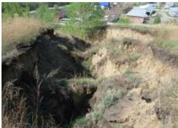
Рис. 148 Развивающийся овраг № 2 (район «Стройрегионгаза») на Тальменском пункте ГОНС, Алтайский край
