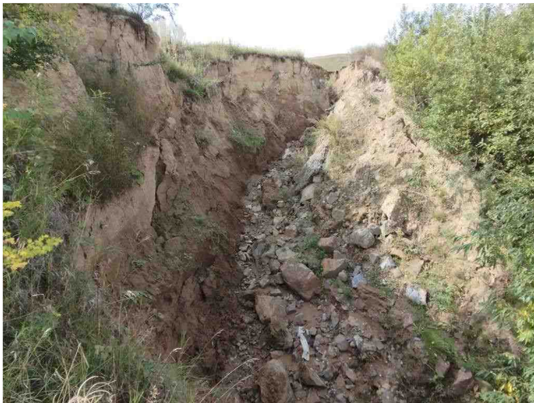
Рис. 2.30 Овраг на участке автодороги Р-255, 29 км. Емельяновский район, Красноярский край
