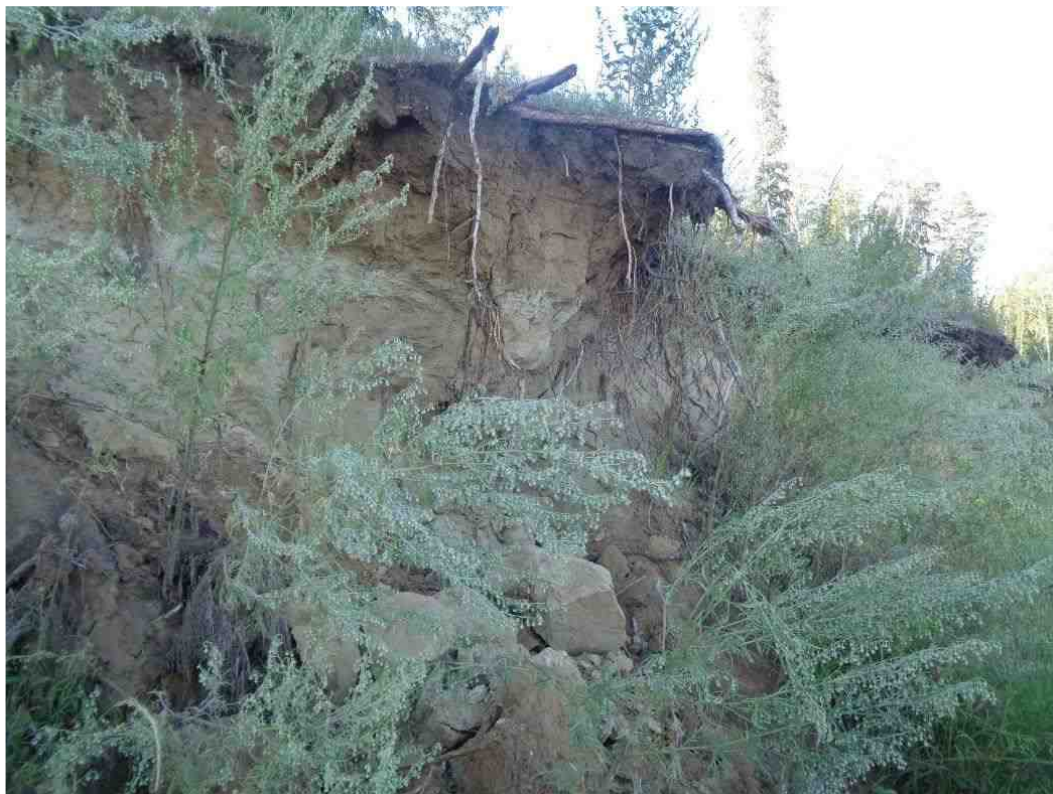
Рис. 2.39 Проявление гравитационных процессов на Быстровском участке. Искитимский район, Новосибирская область
