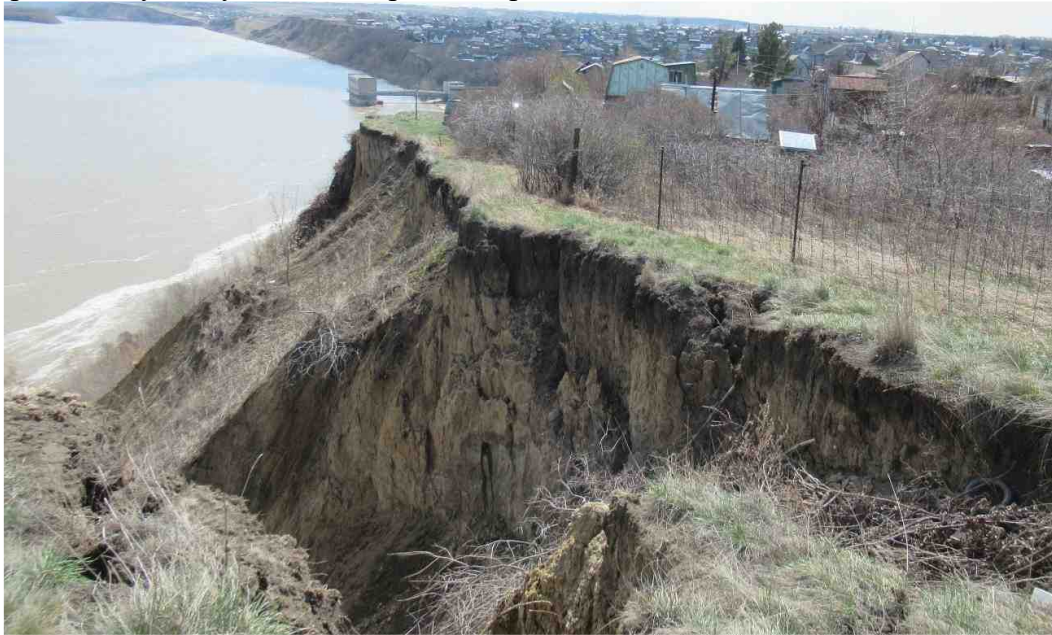
Рис. 2.22 Разрушение оползневого блока в СНТ «Обь». Четвёртый оползневой район, г. Барнаул, Алтайский край
