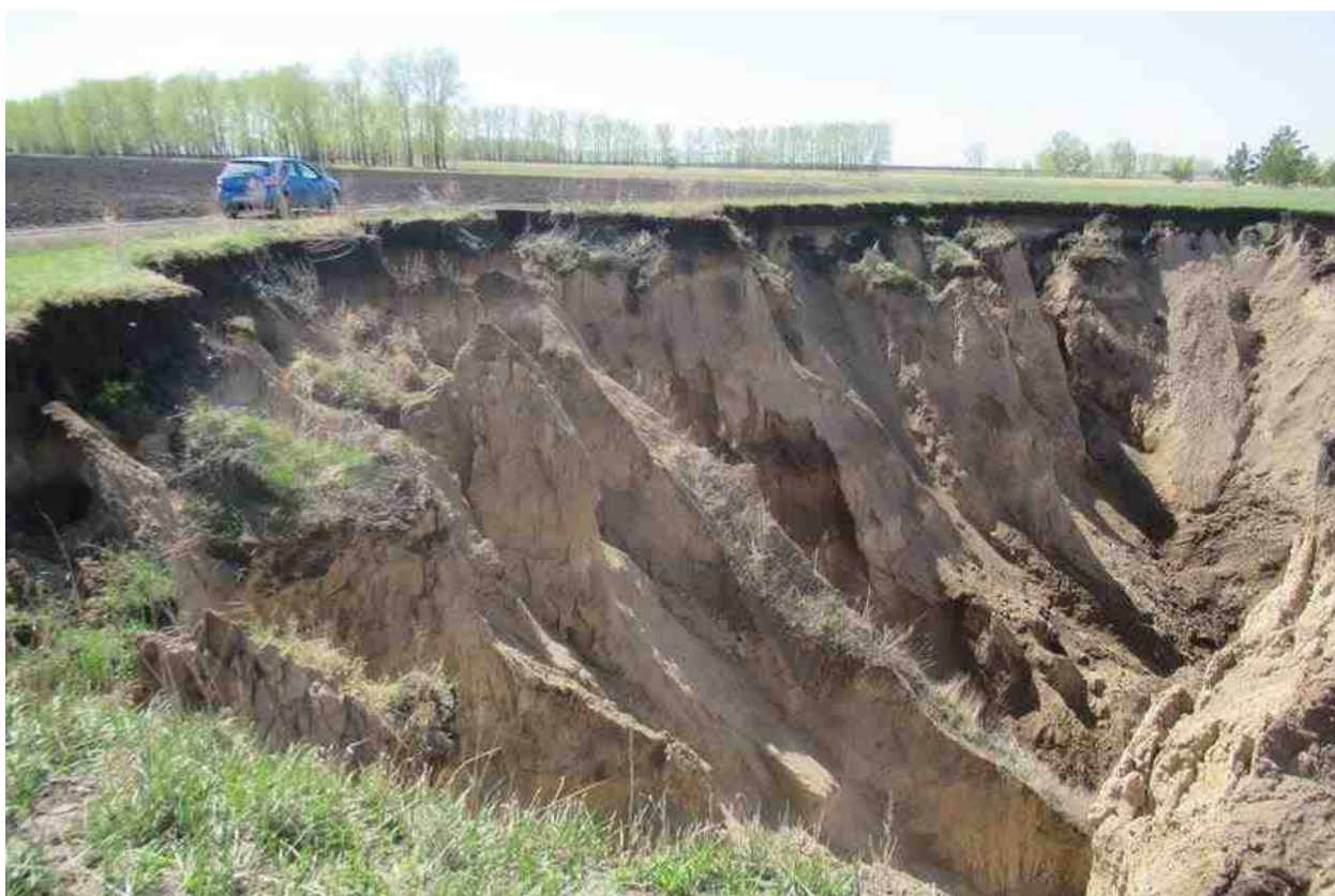
Рис. 2.29 Разрушение бортов оврага № 2 в с. Чернопятово Павловского района, Алтайский край
