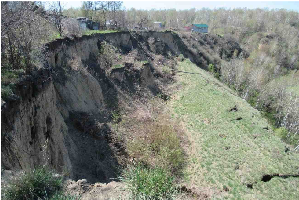
Рис. 2.27 Разрушение оползневого блока в СНТ «Обь». Четвёртый оползневой район, г. Барнаул, Алтайский край
