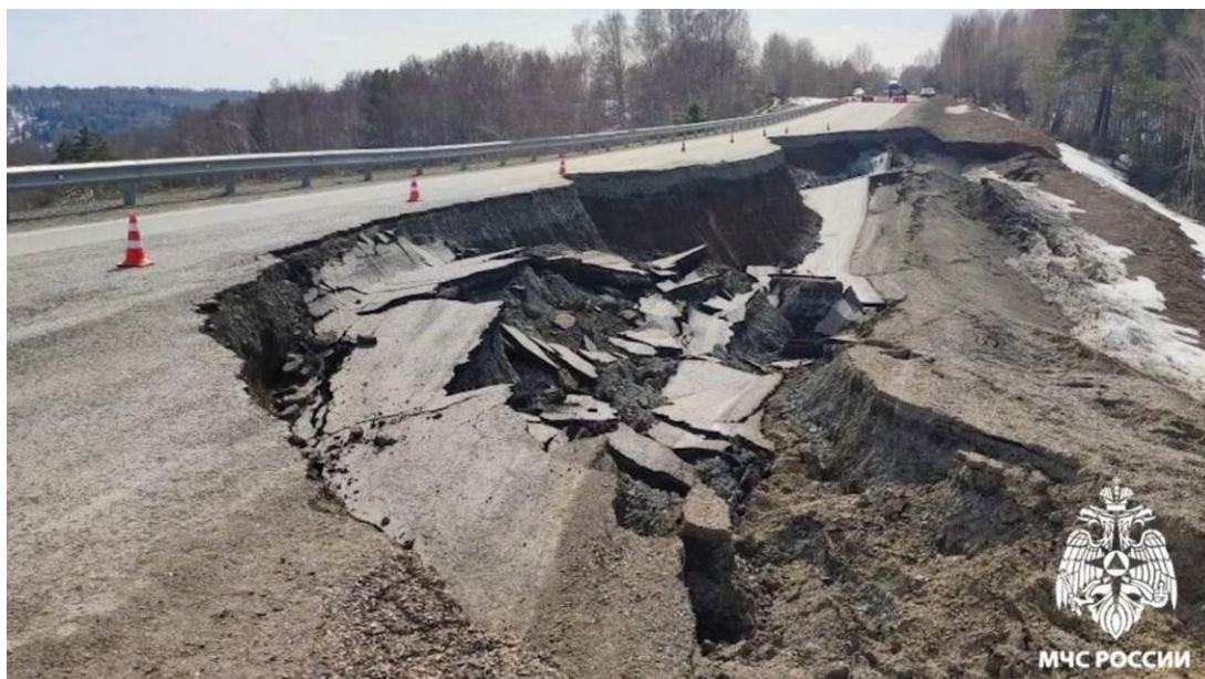
Фото 42-11-00003.а. Вид обрушения уч. а/дороги Р366 Бийск – Мартыново – Кузедеево – Новокузнецк, 186,7-186,8 км в результате активизации оползневого процесса, Новокузнецкий округ, Кемеровская область-Кузбасс, 22.04.2026 ( https://vse42.ru/news/33635521 )
