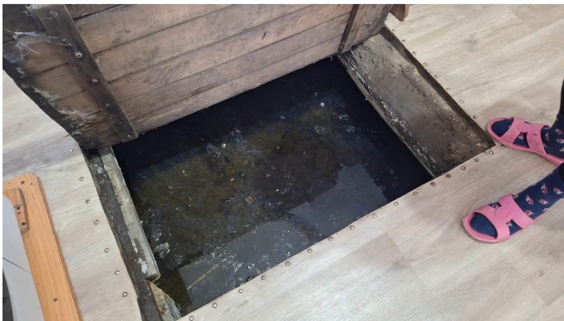
Фото 38-13-00015. Подтопленное подполье по ул. Кедровая, 49, УГВ находится на глубине 0,35 м от поверхности пола, п. Рёлка, г. Иркутск, Иркутская область, 24.05.2026
