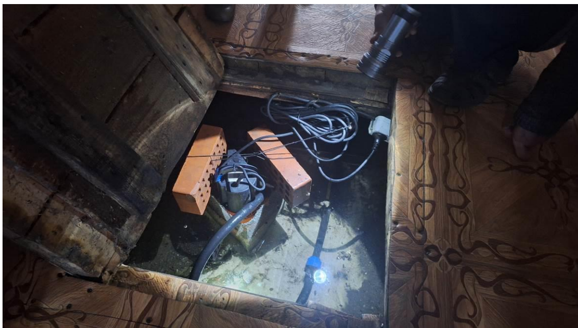
Фото 38-13-00004. Подтопленное подполье по ул. Покрышкина, 52, УГВ составляет 0,32 м от поверхности пола г. Иркутск, п. Жилкино, Иркутская область, 22.05.2026
