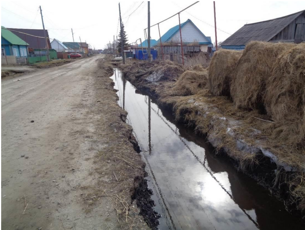
Фото 54-13-00008. По ул. Матросова уровни воды в придорожных канавах находятся на тех же отметках, что и уровни грунтовых вод (около 0,5 м от дневной поверхности). г. Чулым, Чулымский район, Новосибирская область, 17.04.2026
