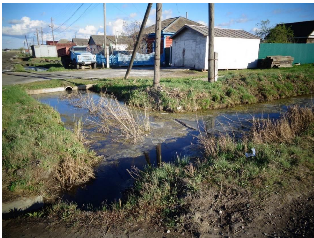
Фото 54-13-00002. Магистральный канал по ул. Краснознаменная заполнен водой, стока нет. Уровень грунтовых вод близок к поверхности. г. Татарск, Татарский округ, Новосибирская область, 06.05.2026
