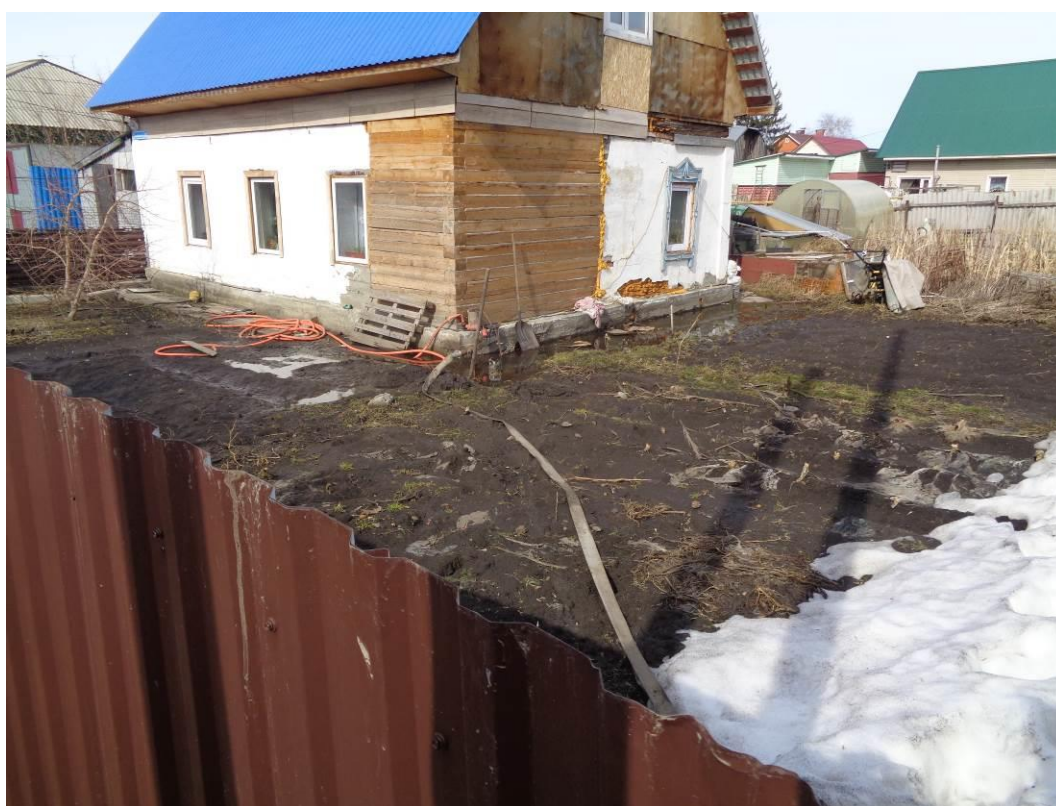
Фото 54-13-00005. Разрушается дом по ул. Октябрьская, 29. г. Бердск, Новосибирская область, 09.04.2026
