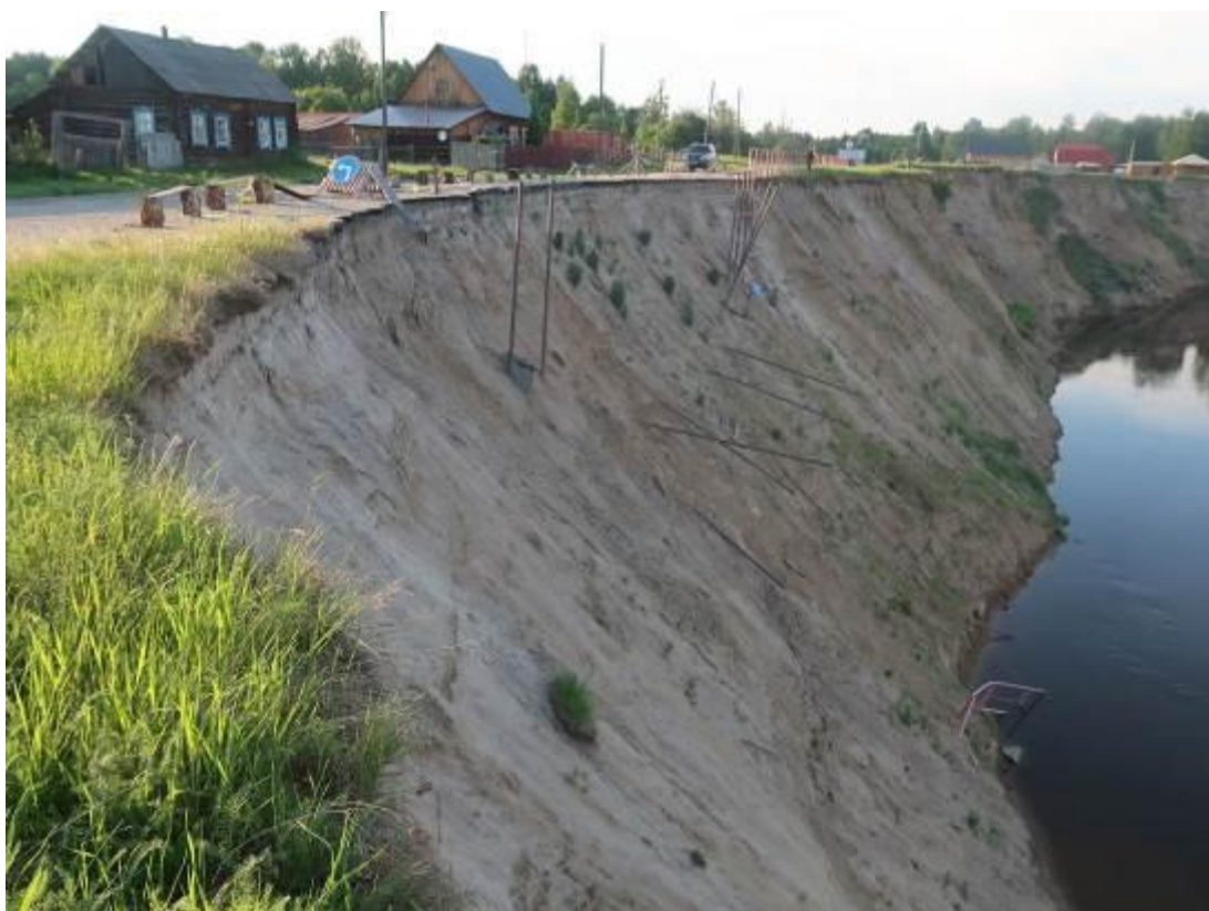
Фото 70-10-00009. Разрушение автодороги и защитного ограждения по ул. Центральная, с. Городок, Первомайский район, Томская область, 10.06.2026
