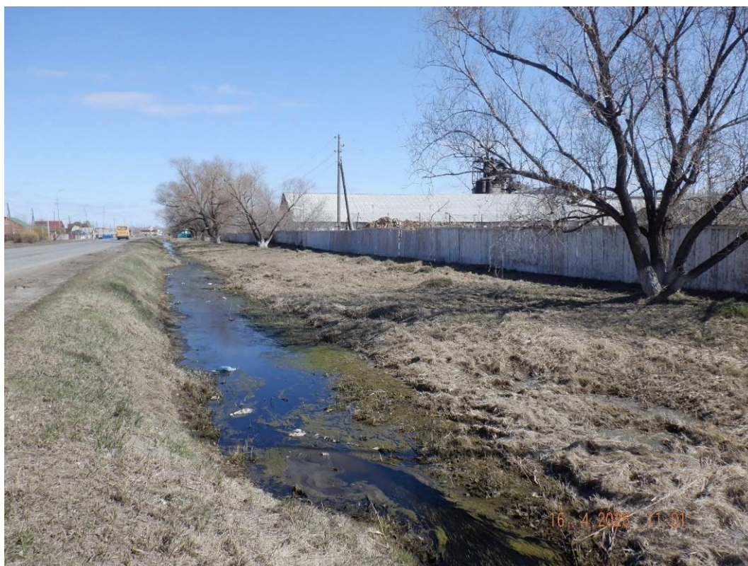
Фото 55-13-00006. Водоотводный канал по ул. Ленина, напротив автовокзала, пгт. Павлоградка, муниципальный округ Павлоградский район, Омская область, 16.04.2026
