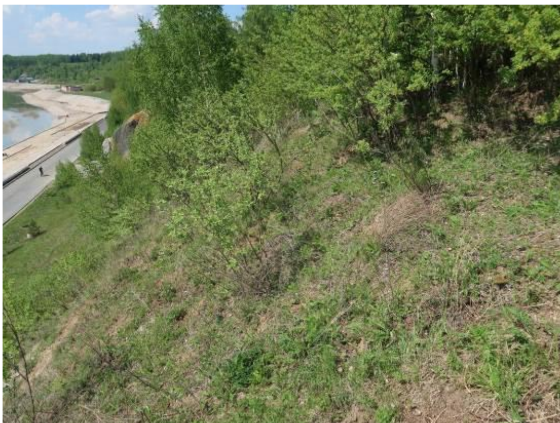
Фото 70-11-00014. Оползень №15а в г. Томске, Лагерный сад, Томская область, 28.05.2026
