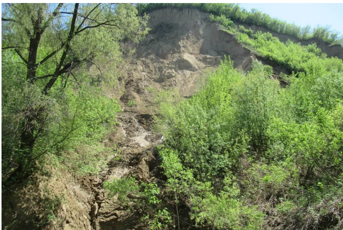
Фото 22-11-00020. Полигенный оползень на левом береговом склоне долины р. Обь на участке ул. Квартал 953а, 380, г. Барнаул, Алтайский край, 09.05.2026
