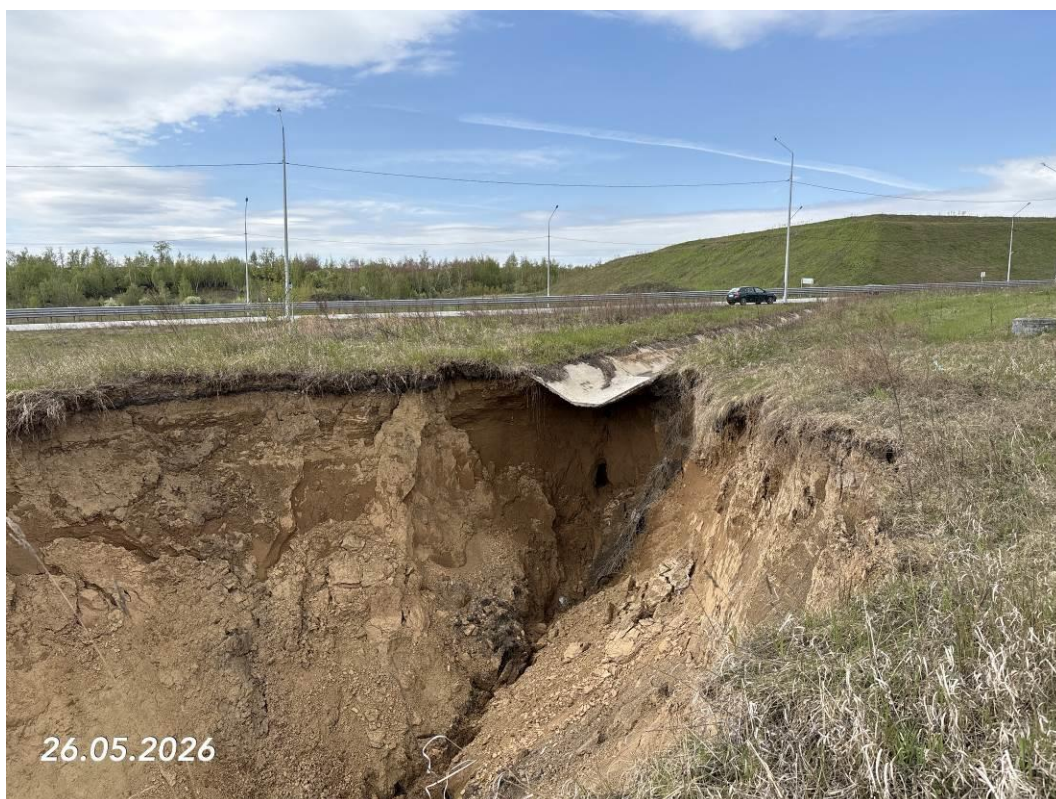
Фото 24-22-00058. Вершина оврага № 1, ПН уч. а/дороги Р-255, 29 км, Емельяновский округ, Красноярский край, 26.05.2026
