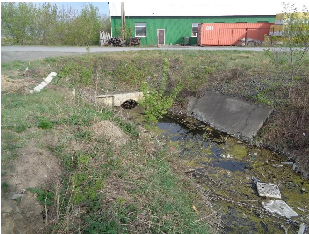
Фото 54-13-00003. Магистральный канал по ул. Октябрьская зарастает болотной растительностью, стенки оплывают, дно заиливается, вода цветёт. Поверхностная и грунтовая вода находится на одной отметке - ниже дневной поверхности на 0,8-1 м. с. Баган, Баганский район, Новосибирская область, 05.05.2026
