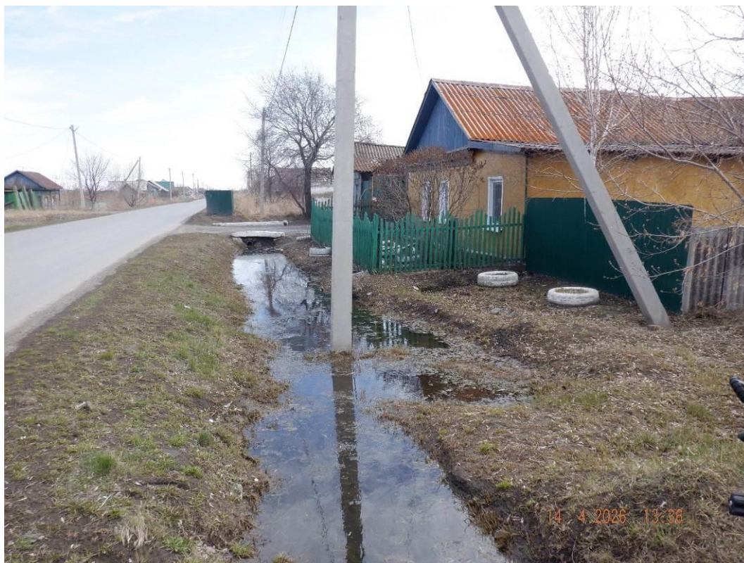
Фото 55-13-00001. Водоотводный канал по ул. Первомайская, 42, г. Называевск, муниципальный округ Называевский район, Омская область, 14.04.2026
