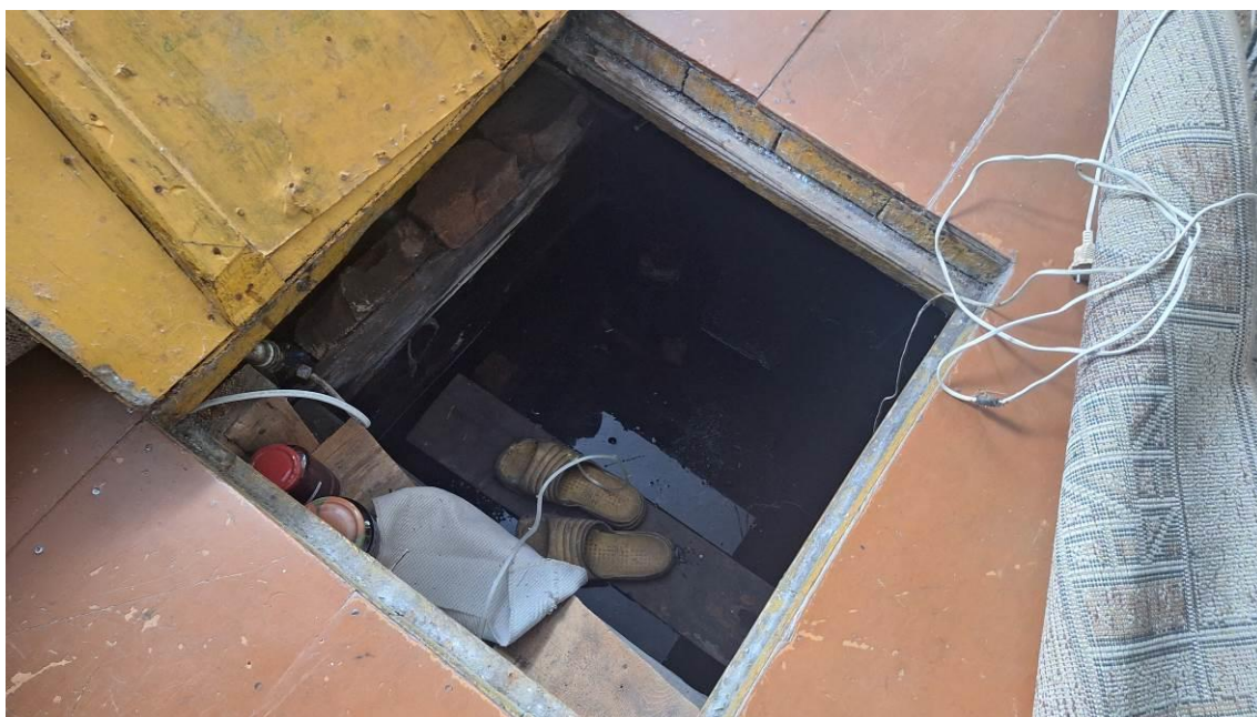
Фото 38-13-00007. Подтопленное подполье по ул. 7-я Кировская, 10, УГВ составляет 0,68 м от поверхности пола, г. Иркутск, п. Кирова, Иркутская область, 22.05.2026
