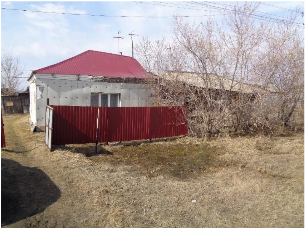
Фото 54-13-00010. Вследствие активизации подтопления грунтовыми водами разрушается дом по ул. Фабричная, 12. пгт. Коченёво, Коченёвский район, Новосибирская область, 22.04.2026
