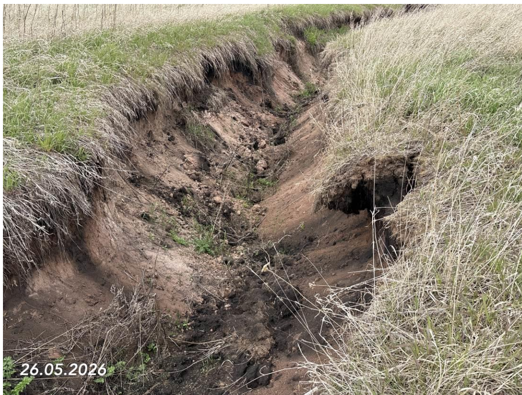
Фото 24-22-00036. Осыпание бортов в точке переуглубления русла, ПН с/х угодья Емельяновского района, городской округ г. Красноярск, Красноярский край, 26.05.2026
