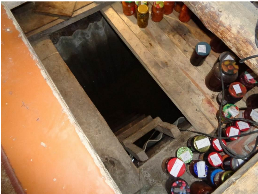
Фото 54-13-00007. Подтоплено подполье грунтовыми водами по ул. Солнечная. с. Лебедевка, Искитимский район, Новосибирская область, 30.04.2026
