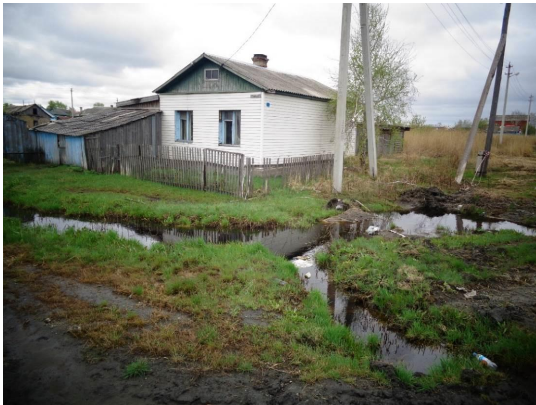
Фото 54-13-00012. По ул. Кошевого уровни воды в придорожных канавах находятся на тех же отметках, что и уровни грунтовых вод (около 0,5 м от дневной поверхности). пгт. Чистоозёрное, Чистоозёрный район, Новосибирская область, 06.05.2026
